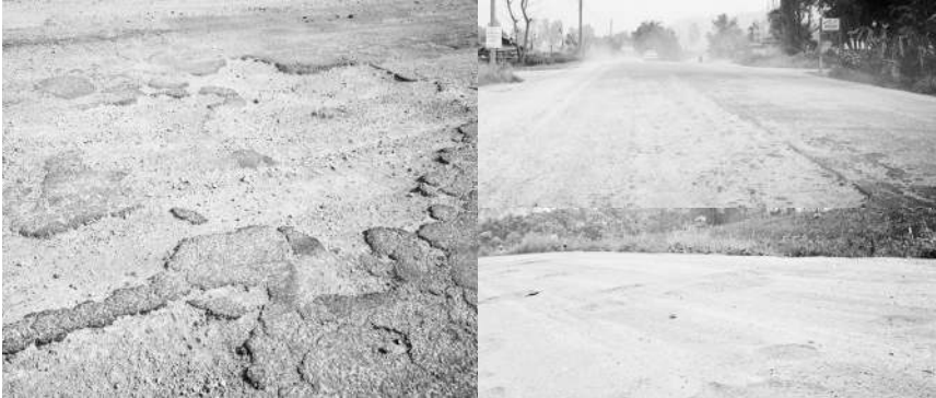
ภาพที่ 4 — สภาพถนนบางช่วงที่ชำรุดเสียหายบนทางหลวงแผ่นดินหมายเลข 1129
